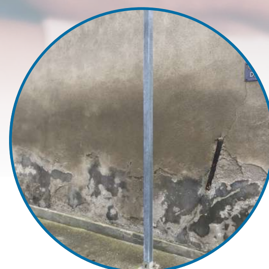
Linha de umidade
