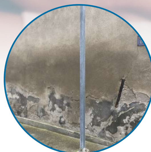
Linea di umidità
