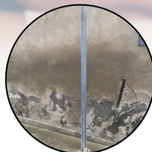
Línea de humedad
