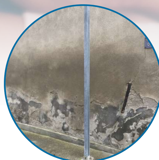
Linea di umidità
